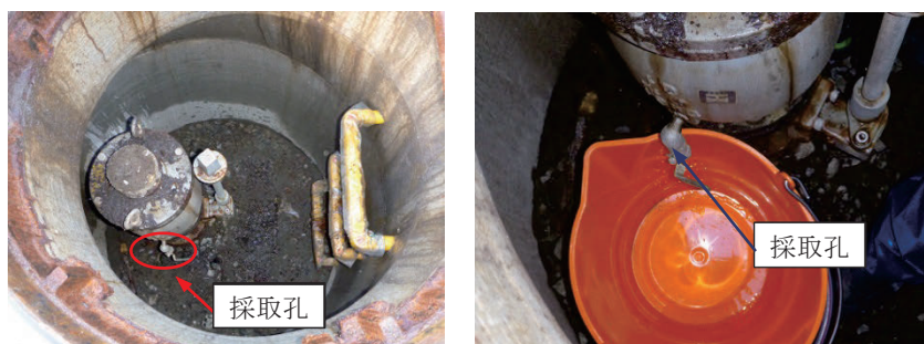
写真1 空気弁の採取孔設置状況の例
