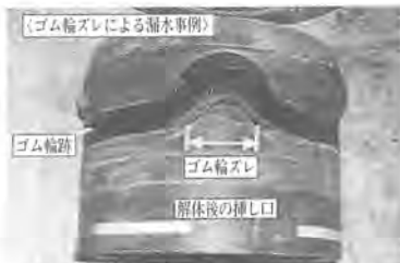
図20 ゴム輪ズレによる漏水事例
